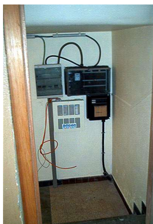
Elektriciteitsmeters en branddetectie-installatie
